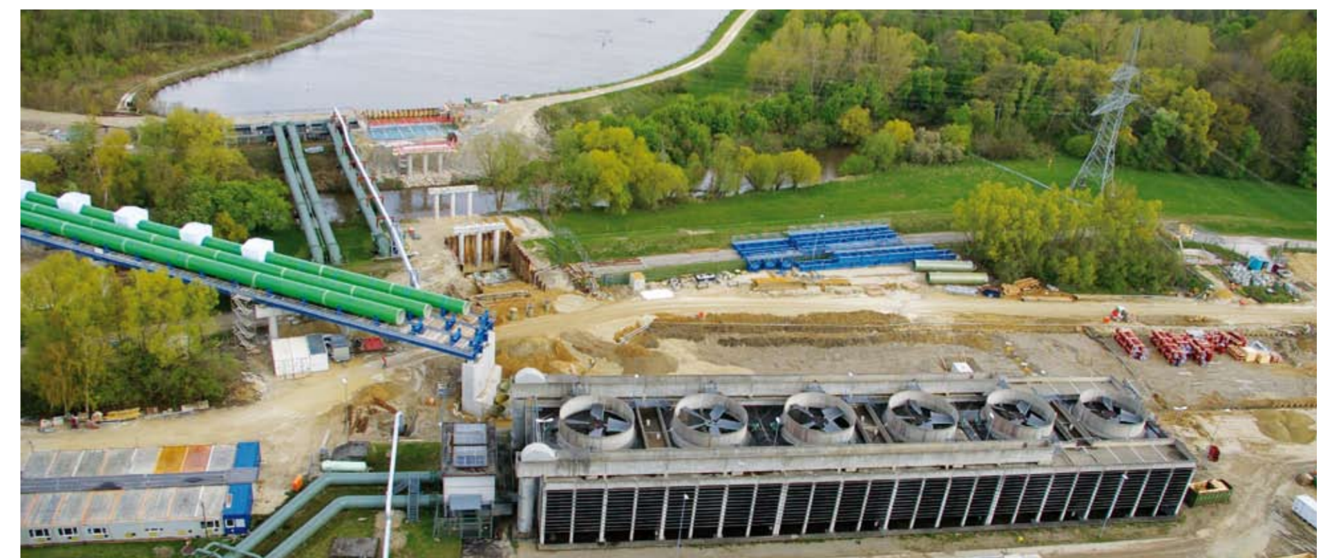
Der Kühlturm in Irsching ist ein Zellenkühlturm und sieht ganz anders aus als herkömmliche Kühltürme
